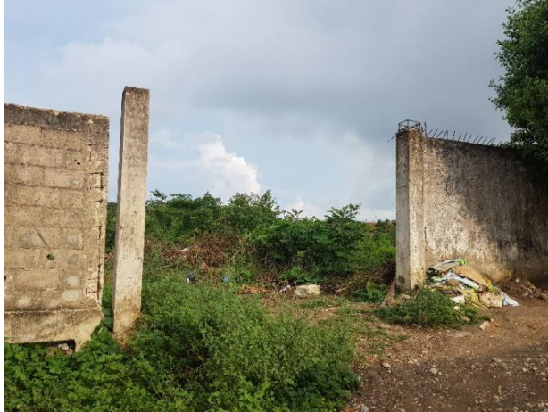
Imagen N° 1: Desplome del muro de cierre perimetral.
