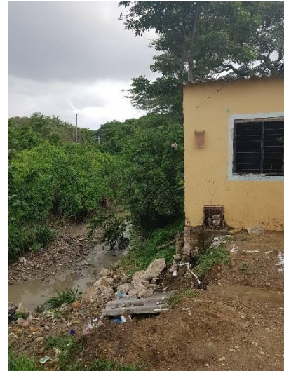
Imagen N° 2: Desplome del muro de cierre perimetral.
